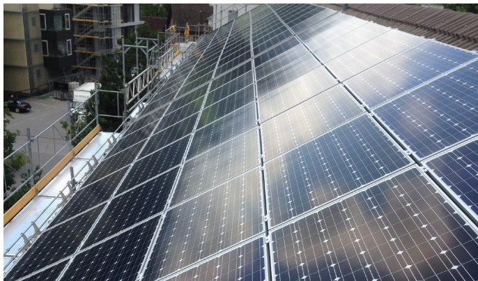
Photovoltaikanlagen auf dem Werkhofgebäude in Au
