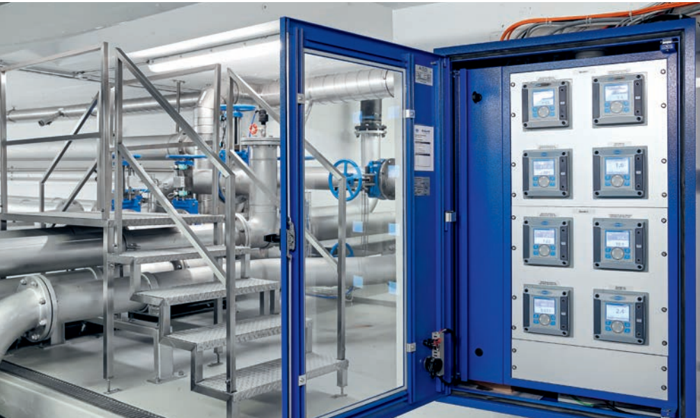
Messverstärkerschrank – Wasserqualitätsstation Pumpwerk Au Nord
