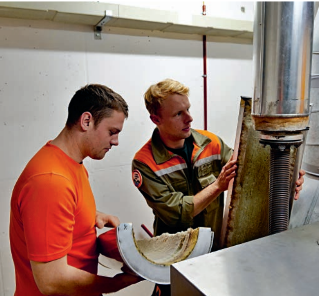
Wiederholungskurs Anlagewarte, Wartung der Zivilschutzanlagen, Kontrolle des Notstromaggregates
