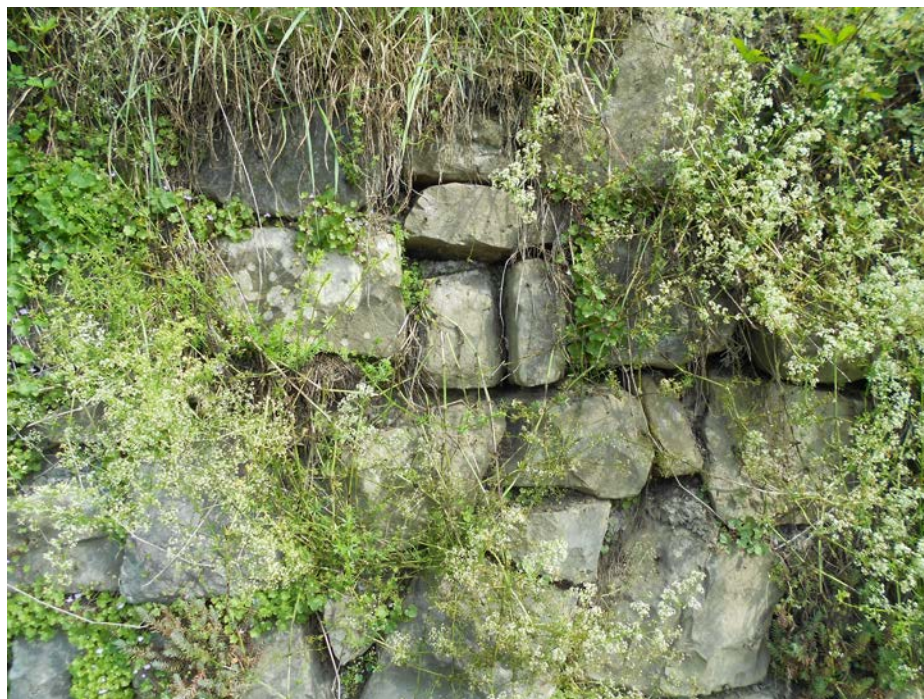
Abb. 1: Punktuell mit Mörtel geflickte Trockenmauer, welche als Schutzobjekt erfasst wurde.
